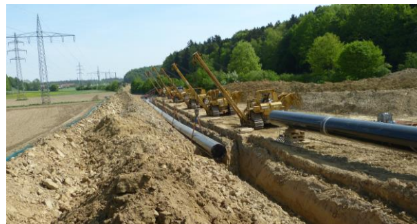
Abbildung: Bau der Gastransportleitung MONACO: Seitenbaumraupen senken den Rohrstrang in den Rohrgraben ab | © bayernets GmbH
