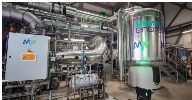
Abbildung: Flusswärmepumpe der MVV Energie AG in Mannheim | © MVV Energie AG
